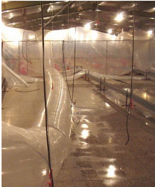
کانال پلاستیکی هوای گرم که در کف کانال حدود ۱۰ سانتیمتر آب وجود دارد
